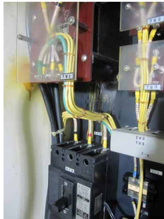
発煙箇所（制御盤内）
