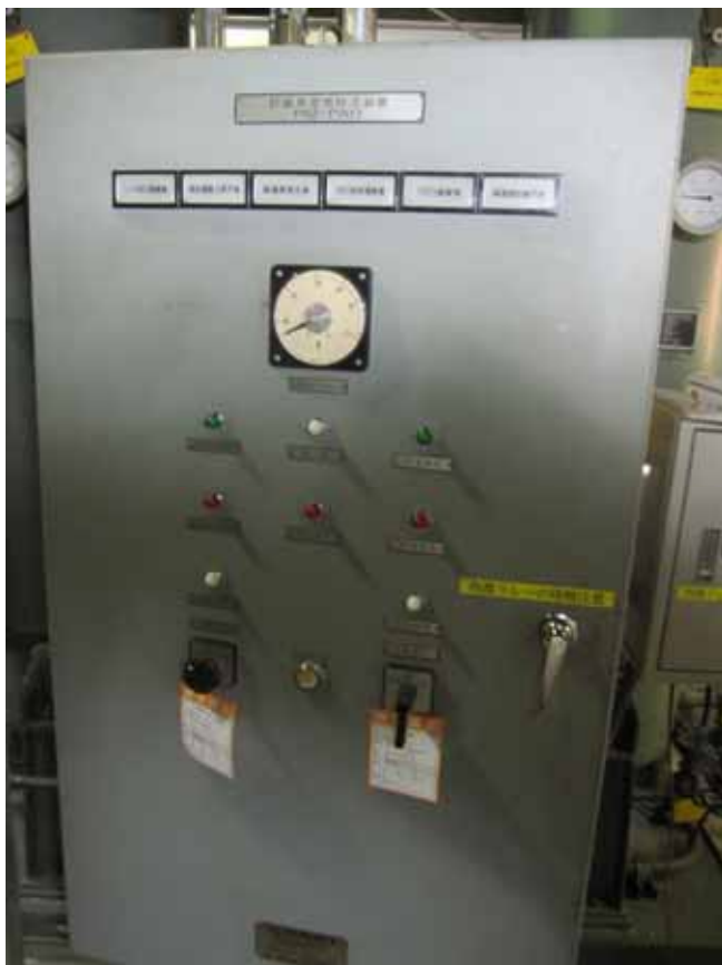
制御用圧縮空気系（I A系）制御盤
