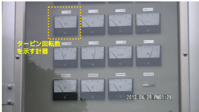
制御車の制御盤（タービン回転数） 平成24年 6月29日 当社社員撮影
