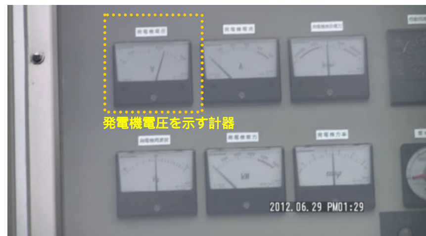
制御車の制御盤（発電機電圧） 平成24年 6月29日 当社社員撮影
