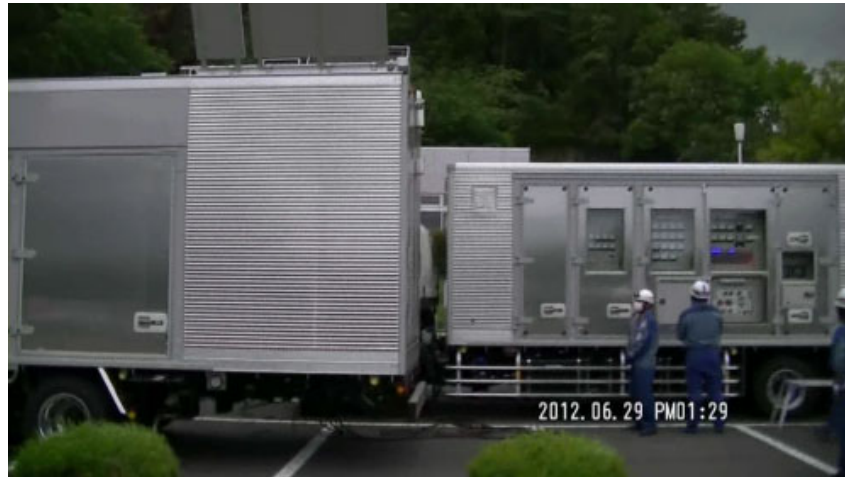
空冷式ガスタービン発電機車（左）と制御車（右） 平成24年 6月29日 当社社員撮影
