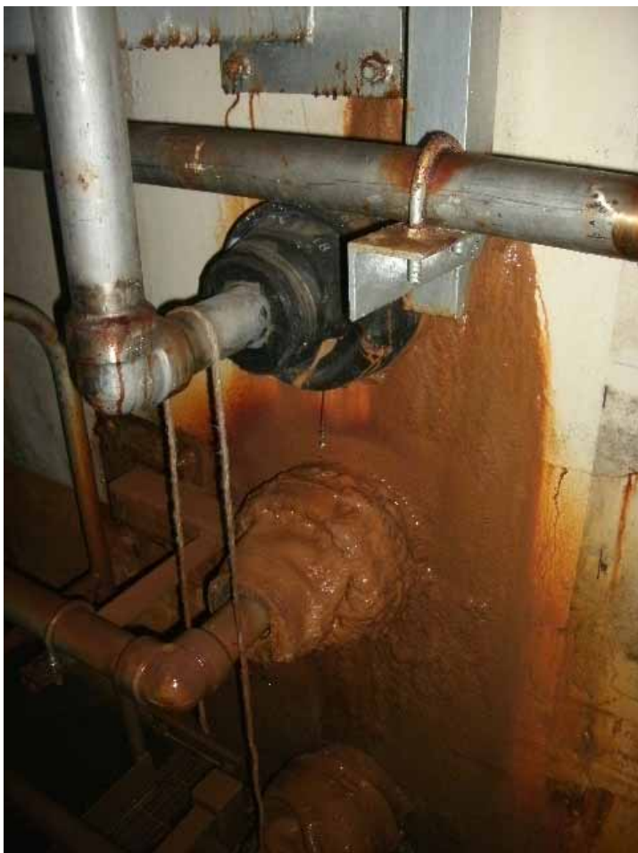
配管貫通部からの流入状況
