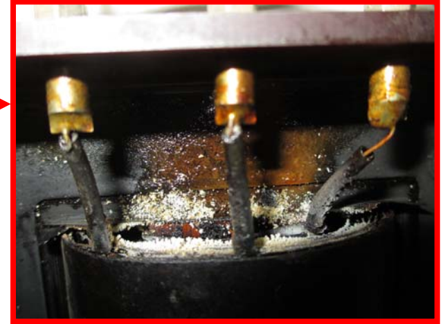
巻線内部が加熱し、絶縁ワニス 溶け出し痕あり
