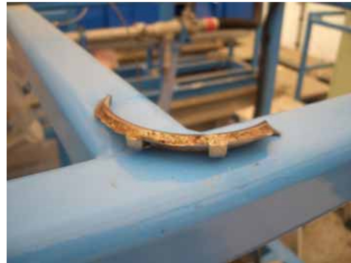
ジョイント部(欠損部)
