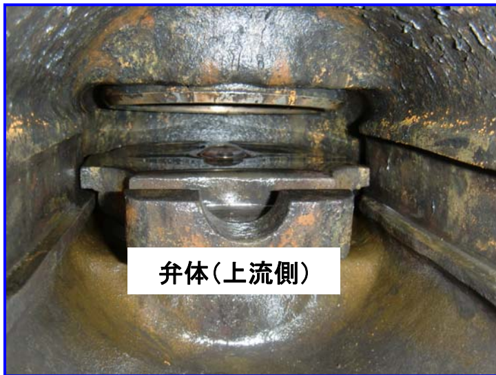
弁棒から外れ、弁箱内部にある弁体（上流側）
