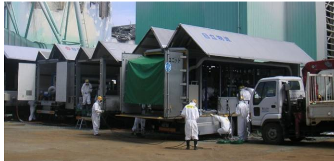
塩分除去 逆浸透膜(RO)装置
