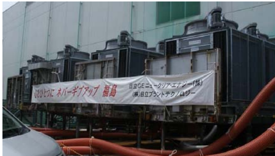
使用済燃料プール 循環冷却装置
