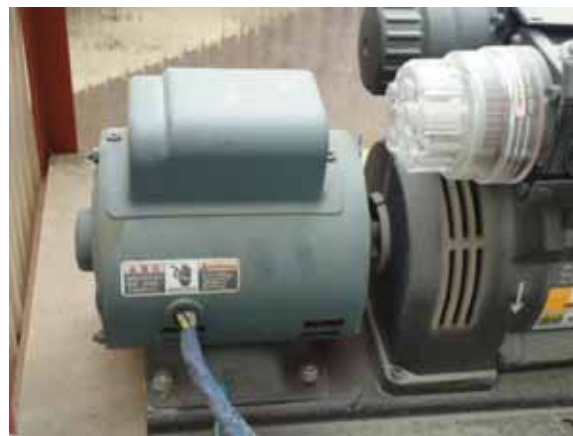
<発煙停止後のHポンプ電動機>
