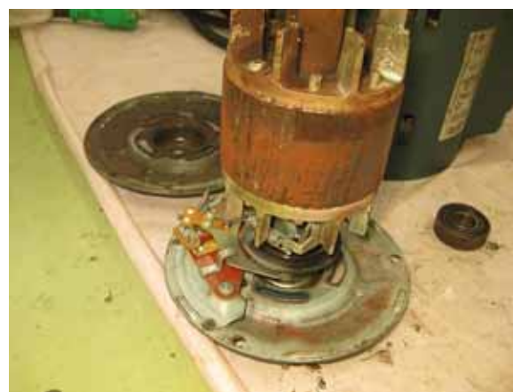
<Hポンプ電動機内部（回転子）>
