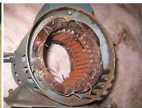
<Hポンプ電動機内部（固定子）>
