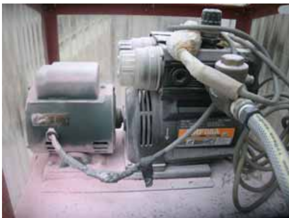
<発煙停止後のGポンプ電動機>
