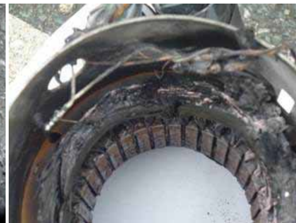
<Gポンプ電動機内部（固定子）>
