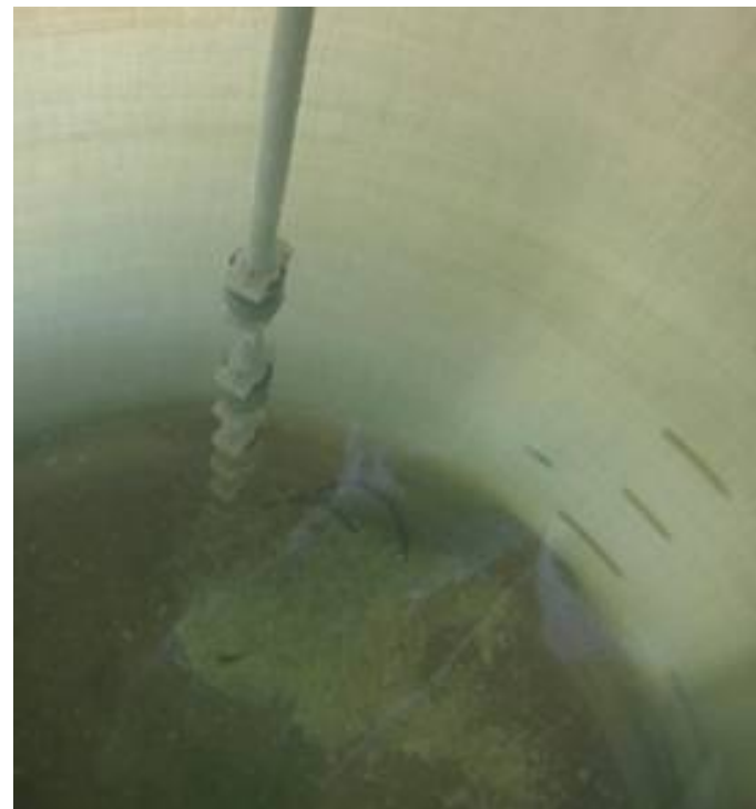
バッファタンク底部に沈殿したスケールを確認
