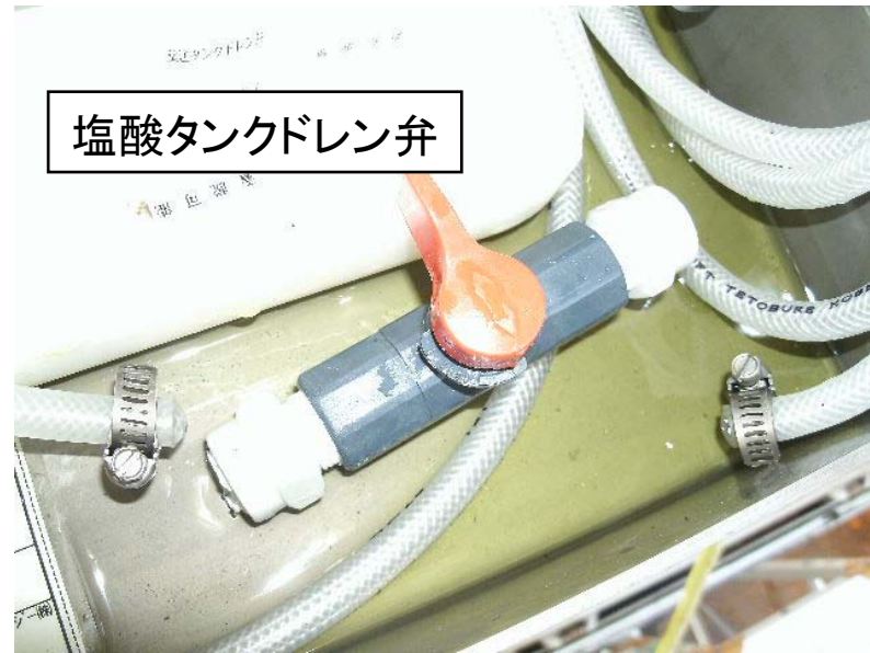
漏えい箇所と考えられるドレンライン接続箇所
