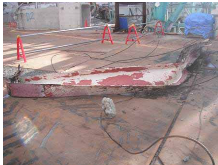
水没した鉄骨がれき （撤去後）
