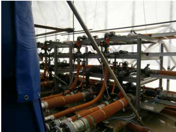
漏えいエリア(全体)
