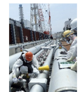
(凍結管バルブ開閉操作の様子)
