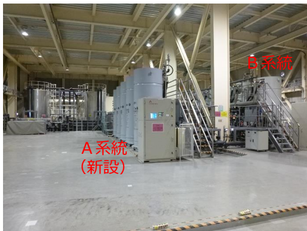
サブドレン浄化装置（全体）
