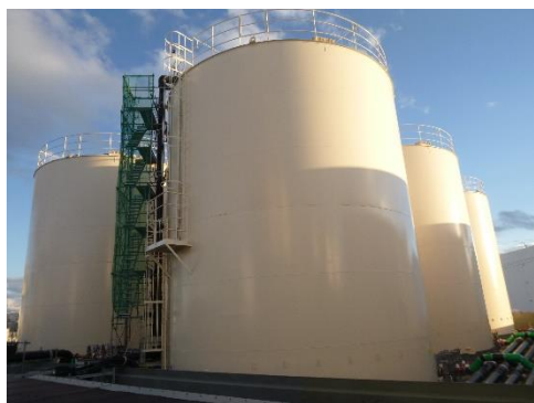
増設一時貯水タンク
