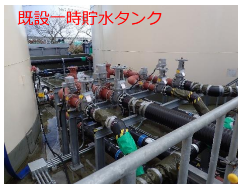
既設一時貯水タンク 二重化ライン
