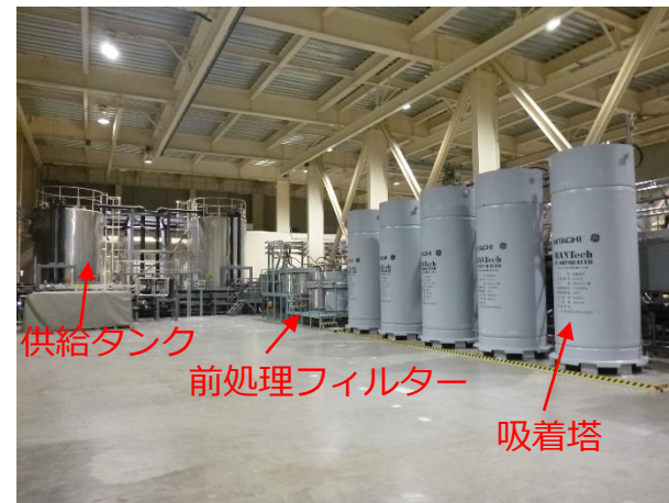
サブドレン浄化装置（新設A系統）
