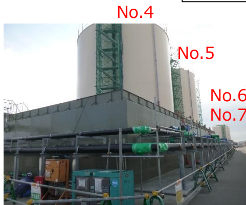
増設集水タンク
