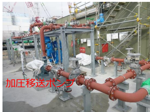
加圧移送ポンプ周り
