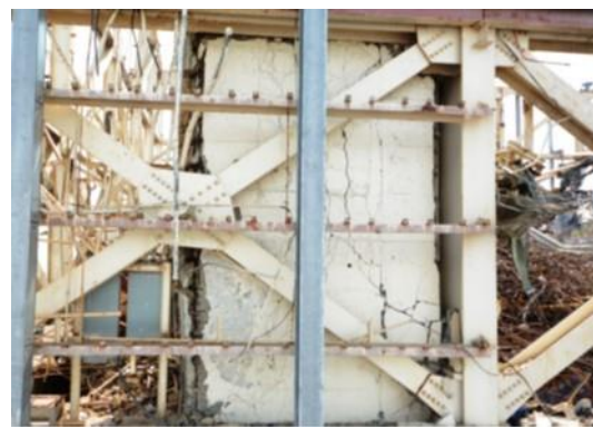
西面の壁状況
