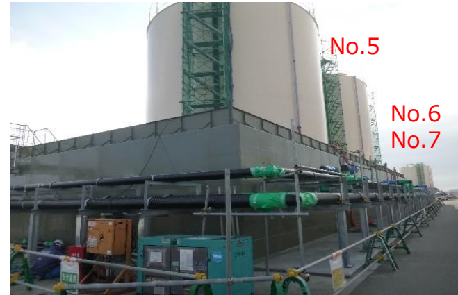
増設集水タンク
