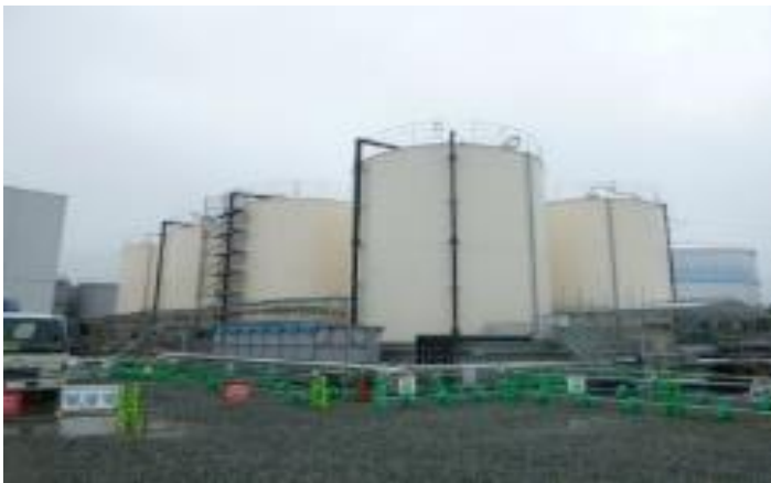
既設一時貯水タンク
