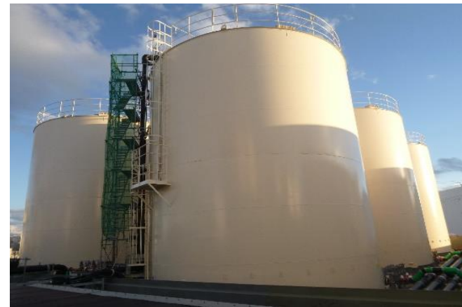
増設一時貯水タンク
