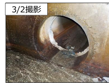
ポンプ稼働後のφ600排水管の状況
