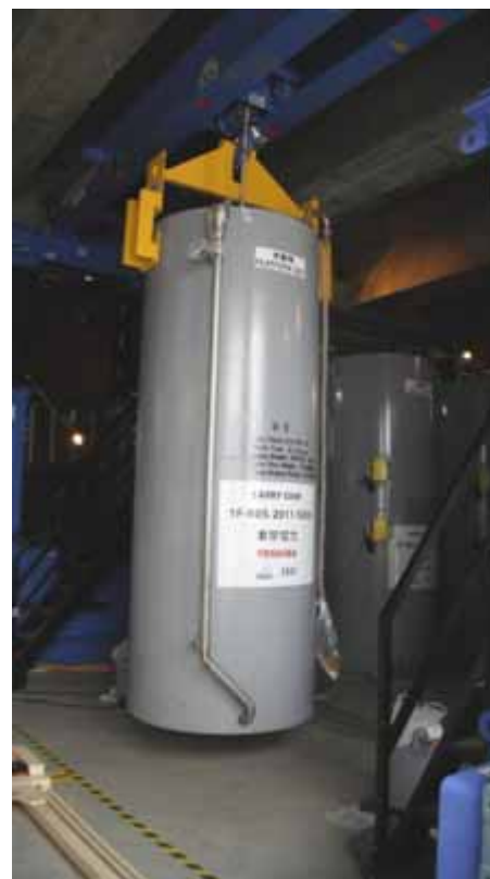
セシウム吸着塔
