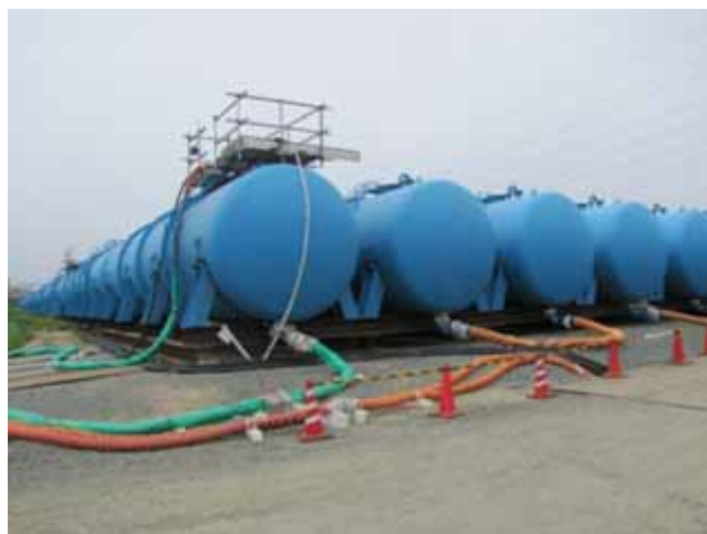
濃縮塩水タンク
