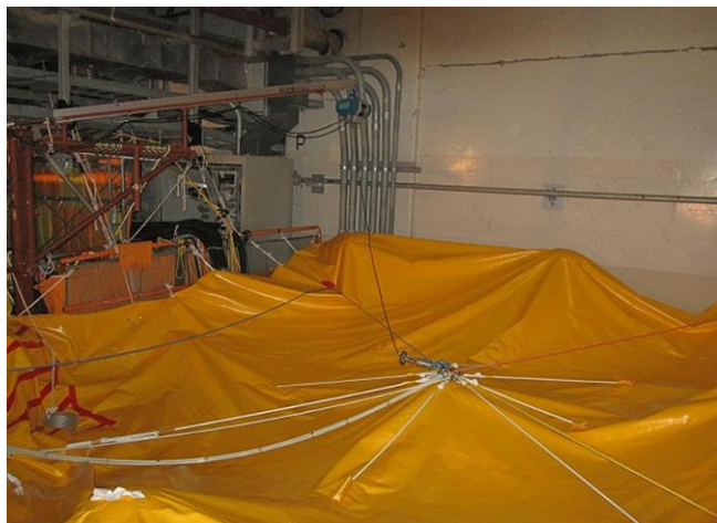
2014年6月の設置状況
