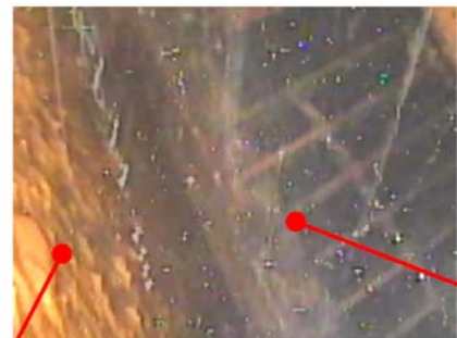
原子炉格納容器内壁 グレーチング（OP. 9500）
