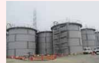
処理水受け用タンク
