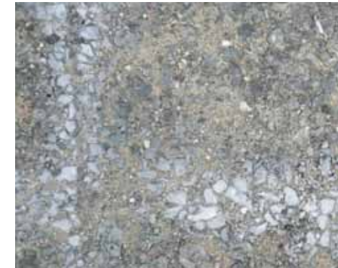
除染前の路面状況
