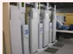
ゲートモニタ設置状況
