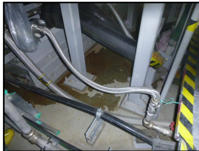
＜漏えいした床面の状況＞
