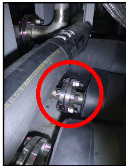
＜配管フランジ＞
