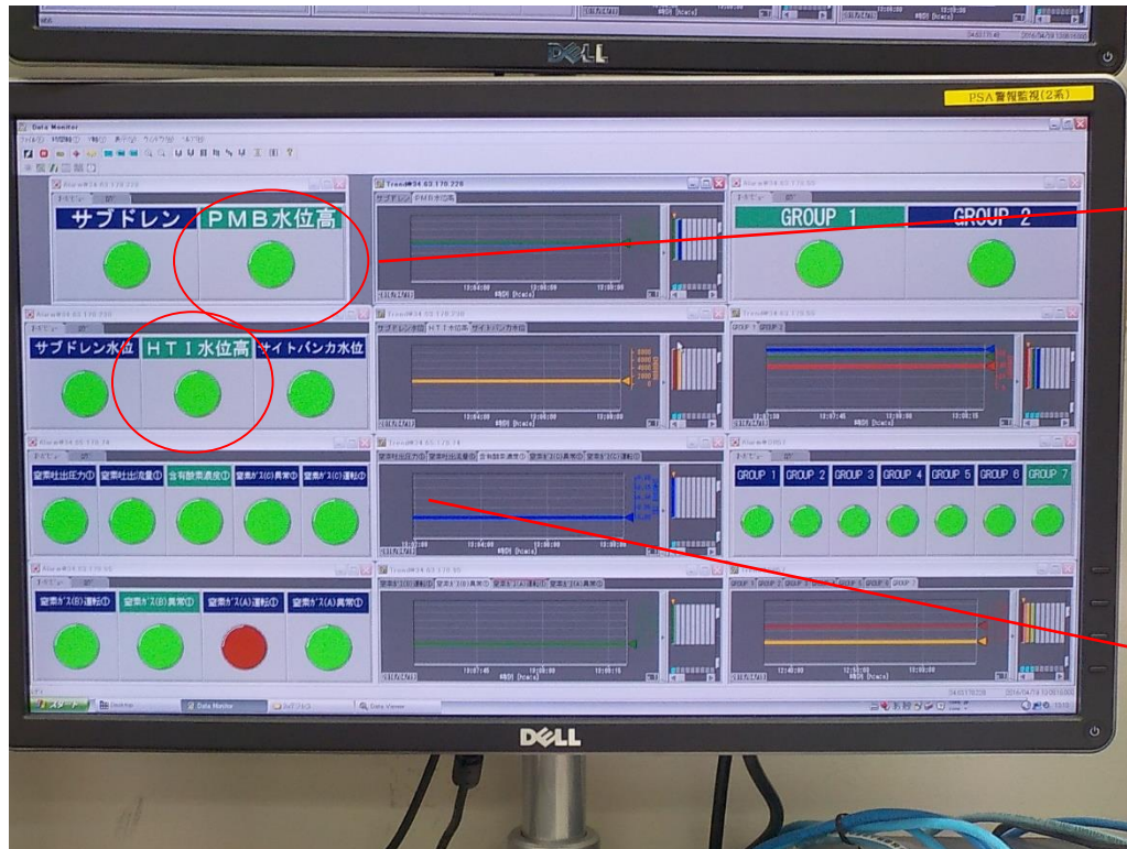
監視画面全景
