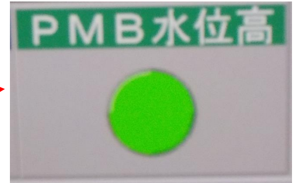
プロセス主建屋（PMB）水位高警報窓
