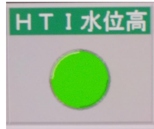
高温焼却炉建屋（HTI）水位高警報窓
