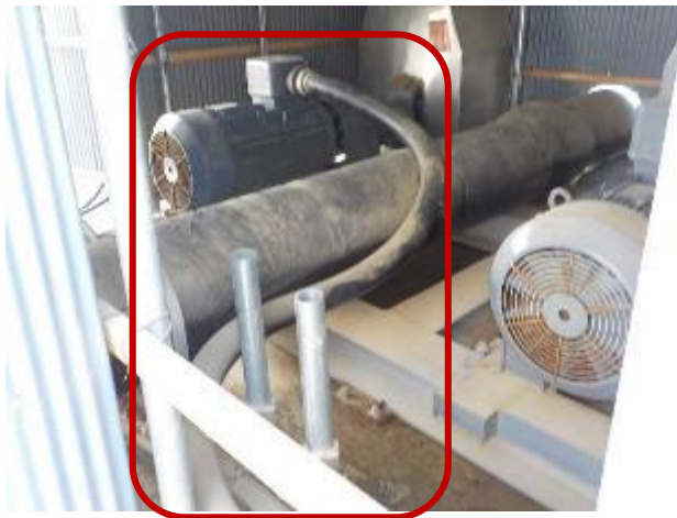
当該電動機設置状況
