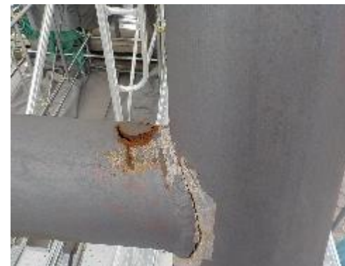
補修前（水平材）
