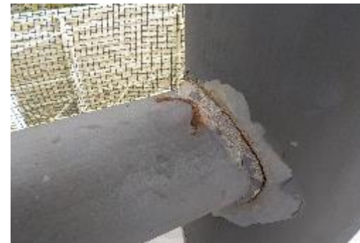
補修前（水平材）
