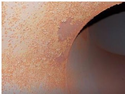
＜排ガス補助ブロアB入口側煙道＞
