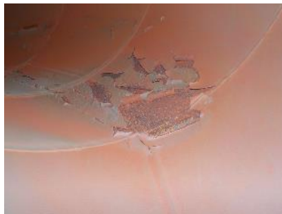
＜バグフィルタB出口側煙道＞
