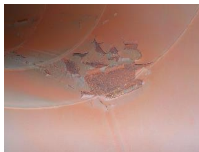
<バグフィルタB出口側煙道>
