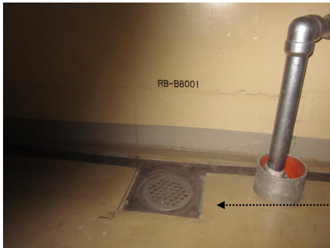
1号機 原子炉建屋（管理区域）残留熱除去系配管スペース室内における放射性物質による汚染 イメージ図
