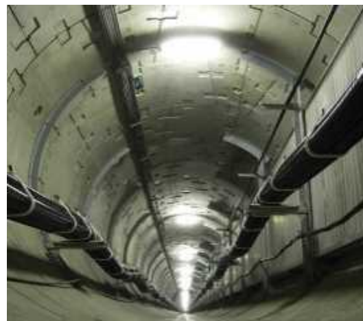
送電設備(地中)
