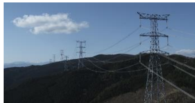
UHV交流送電線
