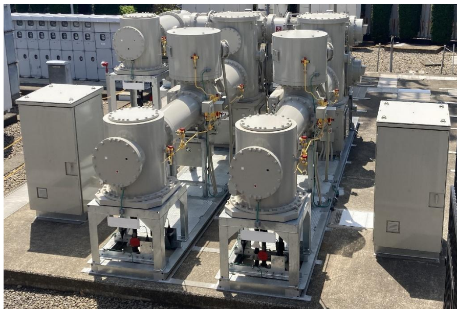
国内電力初のSF 6 ガスを使用しない66kVGIS 〔府中変電所(東京都府中市)〕
