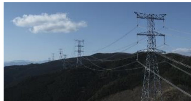
UHV交流送電線
