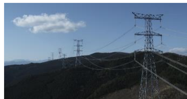
UHV交流送電線
