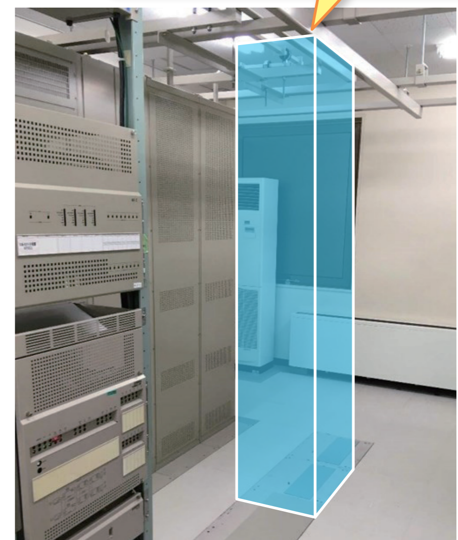
通信機器設置スペース貸し例
