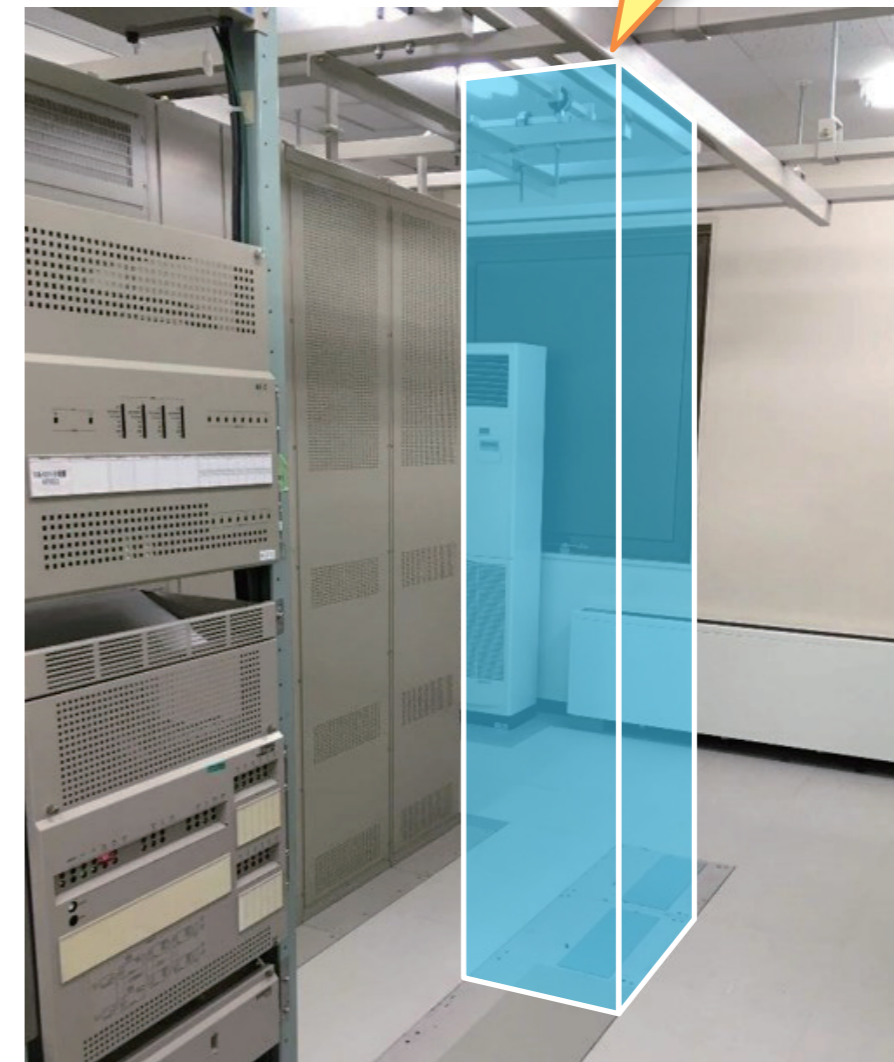
通信機器設置スペース貸し例
