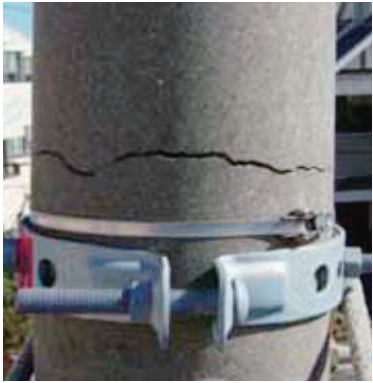
○横ひび・亀裂
