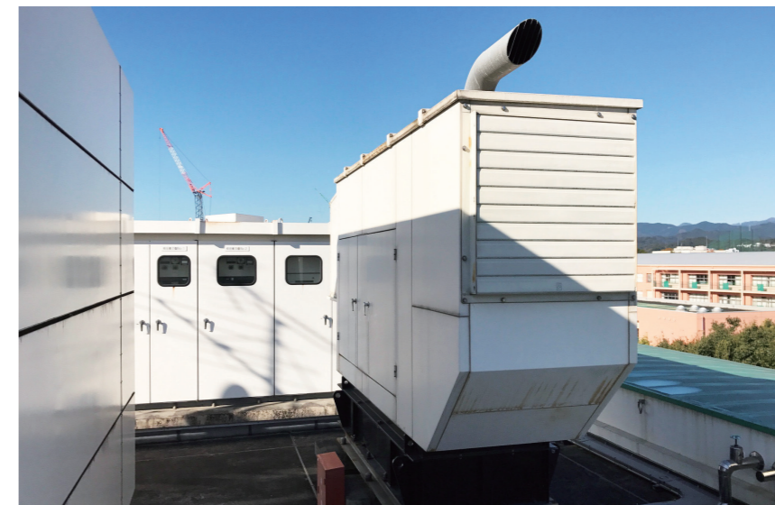
非常用発電機の屋上設置例
