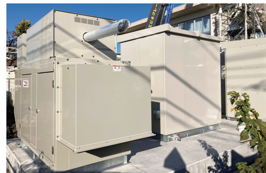
非常用発電機・燃料タンク
