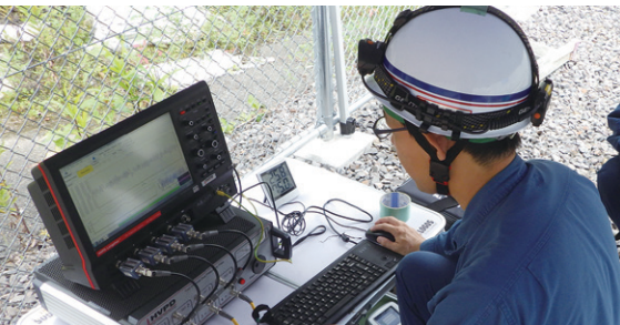
部分放電測定
