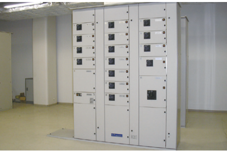
コントロールセンター
