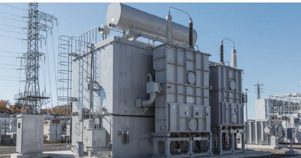
275kV 150MVA 超高压変圧器
