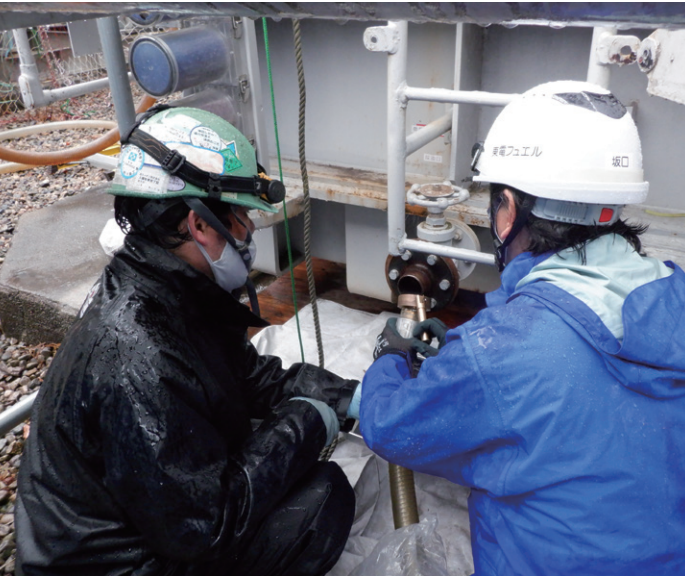
潤滑油の注油作業
