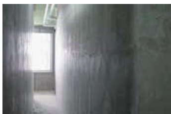
避難通路の壁を不燃材の カルダンウォール標準で施工
