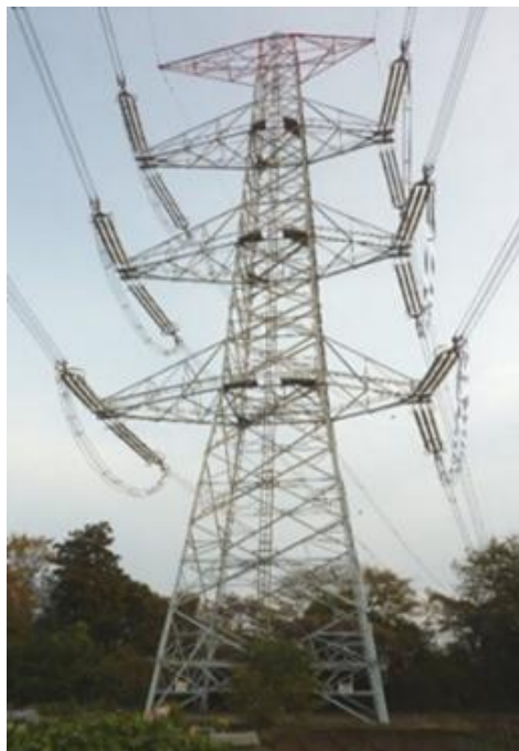
架空送電線 （地上から目に見える）
