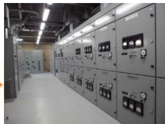
高台電源設備
