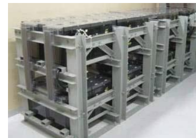
直流電源設備 （原子炉建屋の高所に設置）
