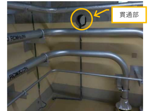
防火壁貫通部の防火処置未実施箇所（2号機原子炉建屋地階）
