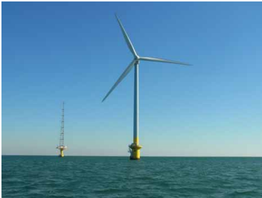
風況観測タワー（左）と洋上風力発電設備（右）
