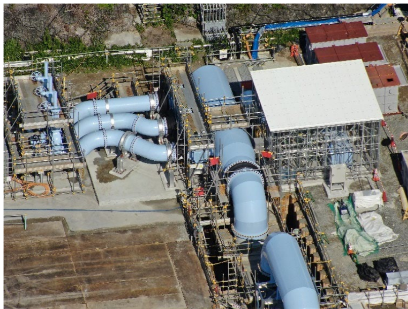
海水移送配管と海水配管ヘッド (海水配管ヘッド：ALPS処理水を海水により混合希釈する) [2023年6月25日撮影]
