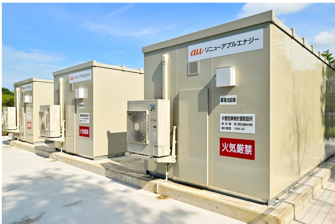
<小山蓄電所の写真>
