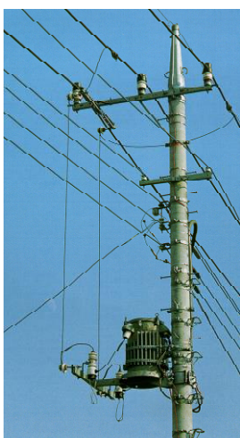
配電線 0.5マイクロテスラ（5ミリガウス） 〈測定ポイント：地表1m〉
