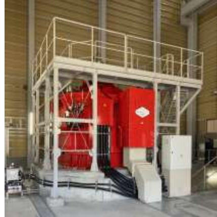
発電機（工事後）
