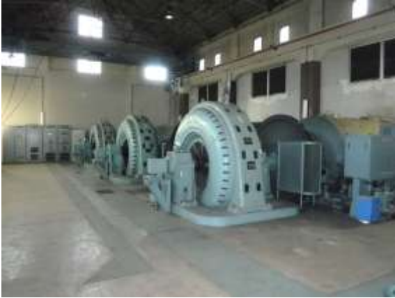
発電機（工事前）
