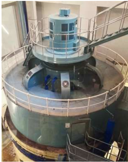
発電機（工事前）
