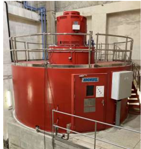
発電機（工事後）
