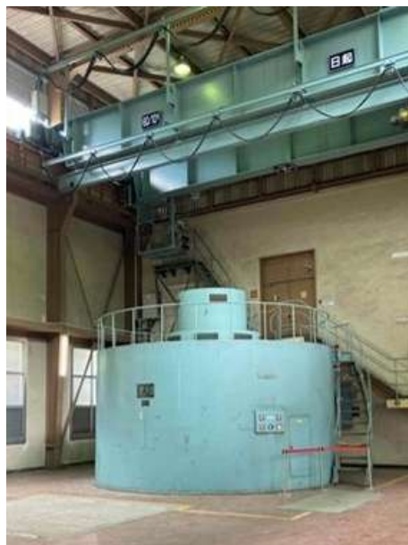
発電機（工事前）
