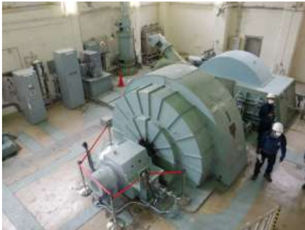
水車発電機（工事前）
