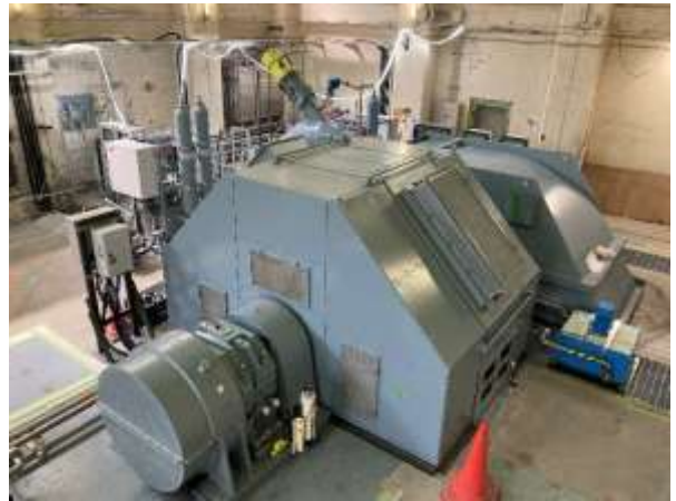
水車発電機（工事後）
